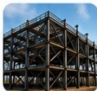
سازه های فلزی
